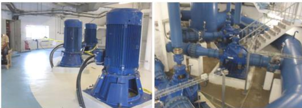
Рисунки 8-9. Насосно-фильтровальная станция
